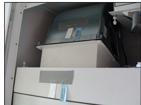
BIs placed inside negative plenum
